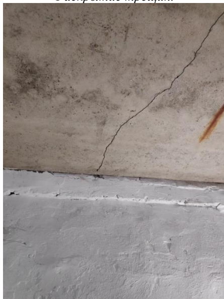
Рисунок 2 Трещины в плитах перекрытия
