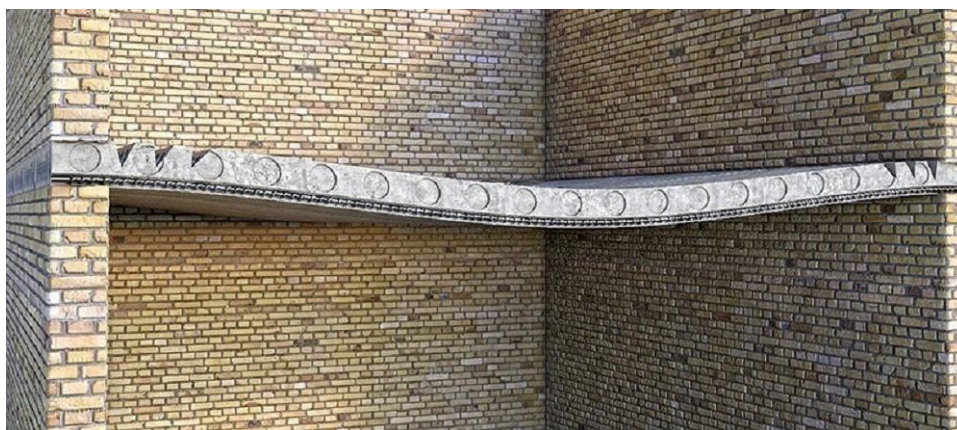
Рисунок 1 Прогиб плит перекрытия
