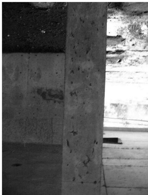
Рис. 2 Отклонение оси колонны происходит чаще всего при возведениях от вертикали (крен) конструкций перекрытий/покрытий (ригелей, фермы и плиты) непроектных размеров.
