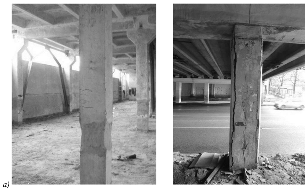
Рис. 3. Трещины в теле бетона: а – поперечные трещины; б – продольные трещины
