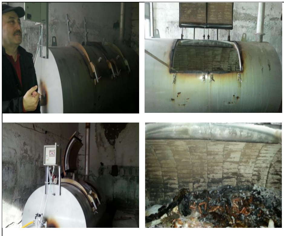
Рис. 2. Процесс термического обезвреживания биологических отходов на установке ГБУ «Ветубой» по ул. Тельмана.
