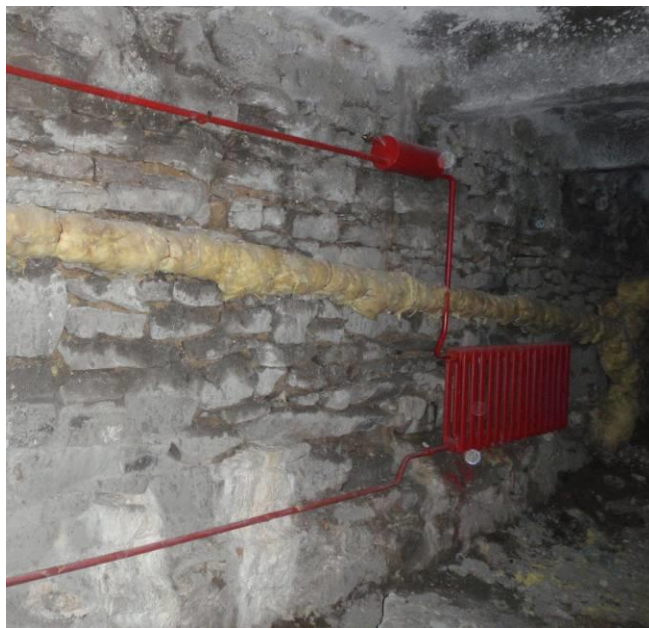
Рисунок 1. Разрушение растворной части кладки в подвале
